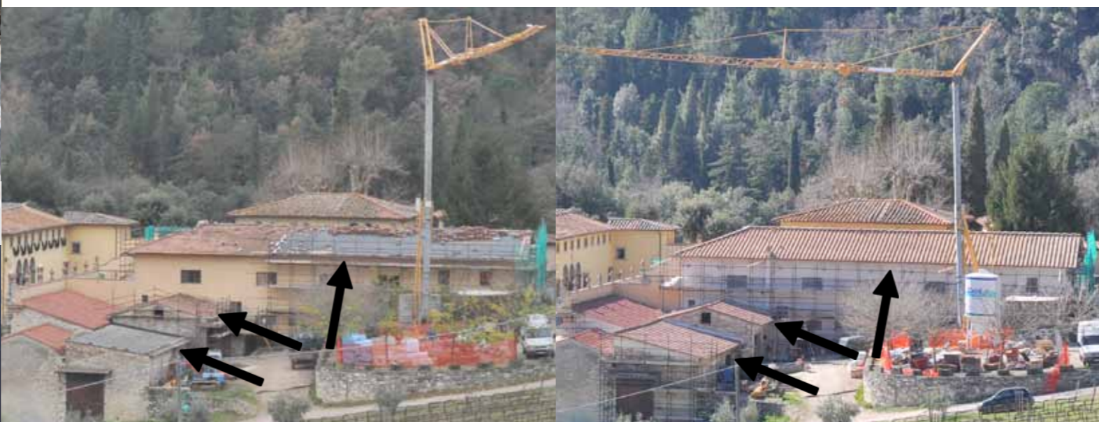
Vue d'ensemble du chantier de la Phase n°3 : à gauche, au début du mois de décembre 2016 et à droite au mois de mars 2017.
