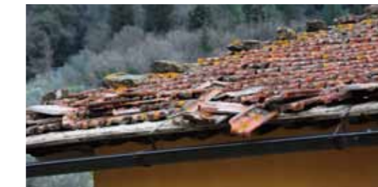
Tuiles du bâtiment Sainte-Marie en mars 2015
