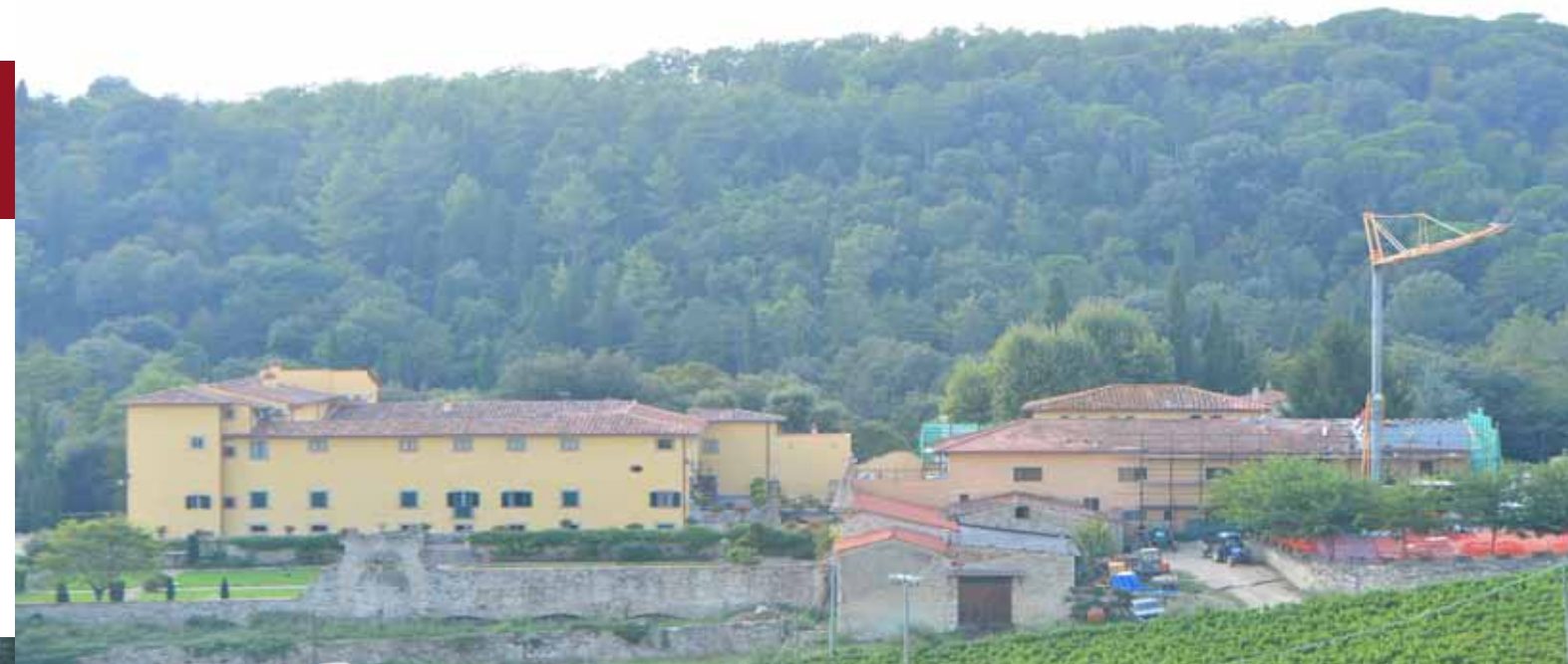
Veduta del Seminario: la Villa Martelli a sinistra, rinnovata tra il 2014 ed il 2015, l'edificio Santa Maria a destra, in corso di restauro.
